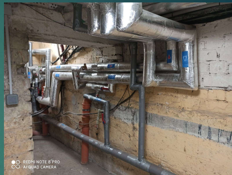
Pav. Požeminis inžinerinių tinklų kolektorius
